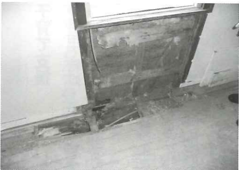
蟻害が発生した詰所
